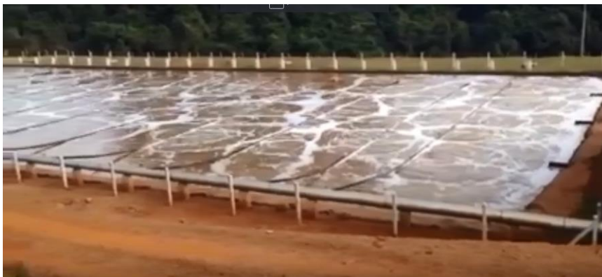
Figura 8: Lagoas de Estabilização – Lagoa Aerada.
